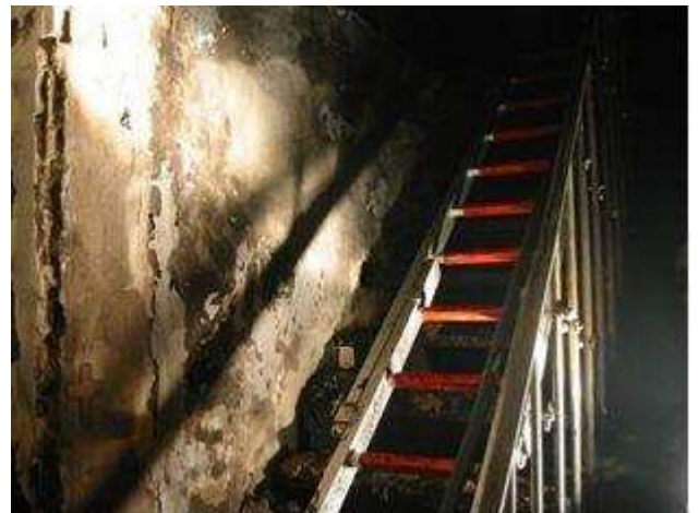
Oft sind die Treppen nicht mehr begehbar!
